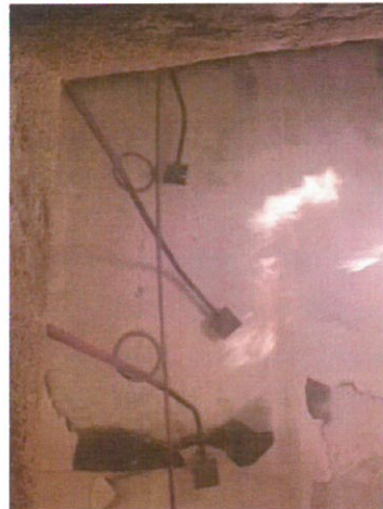
Bild A6.4 Prüfminute 11: Oberfläche der Feuerschutzplatten ist wieder aufgehell, Fugenspachtel ist teilweise herausgefallen.
