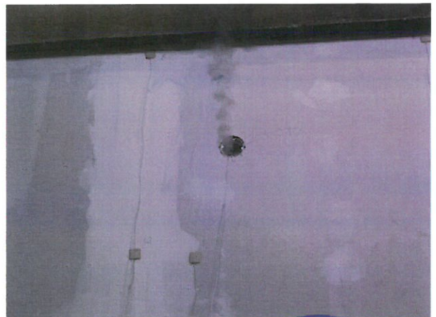
Bild A6.6 Prüfminute 57: Anhaltender Rauchaustritt aus der Installationsdose.
