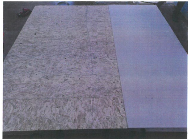
Bild A5.2 Blick von der Rähmseite, Beplankung mit Feuerschutzplatten auf der Lage aus OSB/4- Platten.
