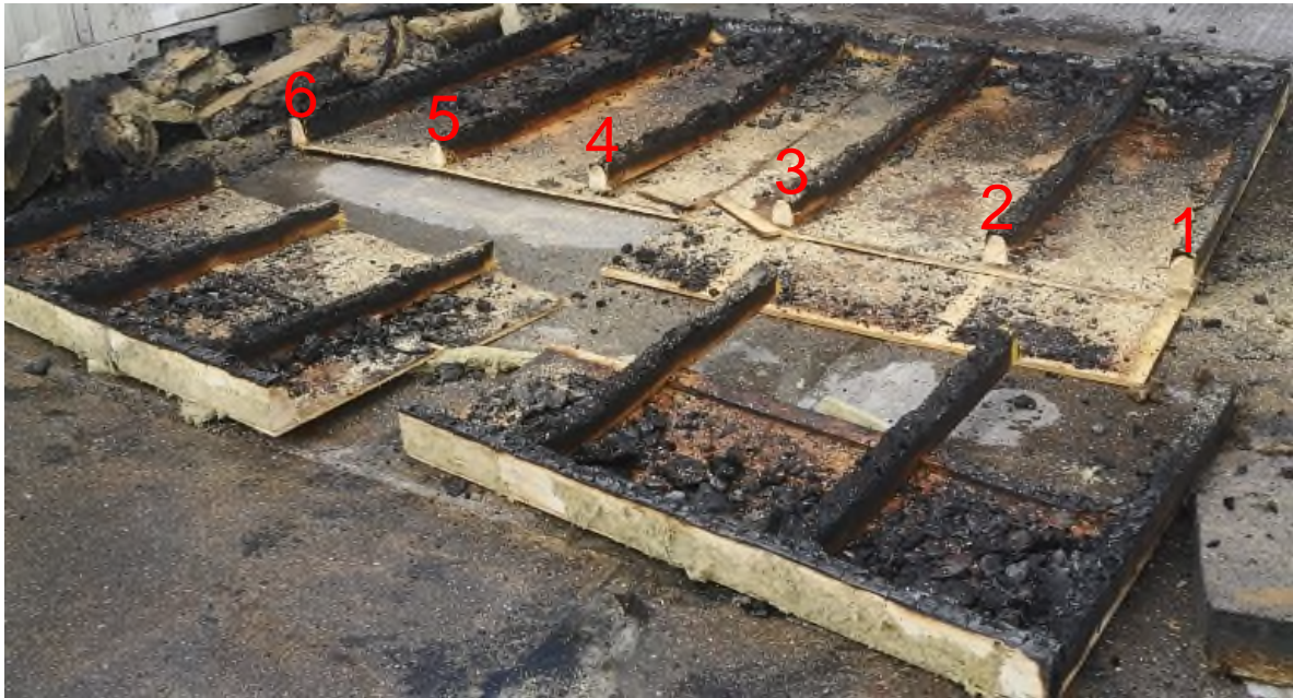
Bild 11 Blick auf den abgelöschten Probekörper; Reste der Gefachdämmung entfernt; Ständer (fortlaufend nummeriert) zur Dokumentation ihrer Restquerschnitte ca. 1000 mm vom oberen Probekörpertrand aufgetrennt.
