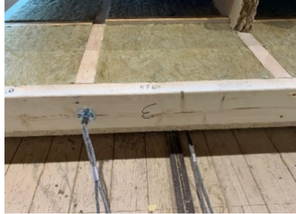
Bild 2 Ansicht auf die eingesetzte Gefachdämmung vor dem Bepanken/Bekleiden der feuerzugewandten Wandseite mit vorbereiteter Hinterlegung.
