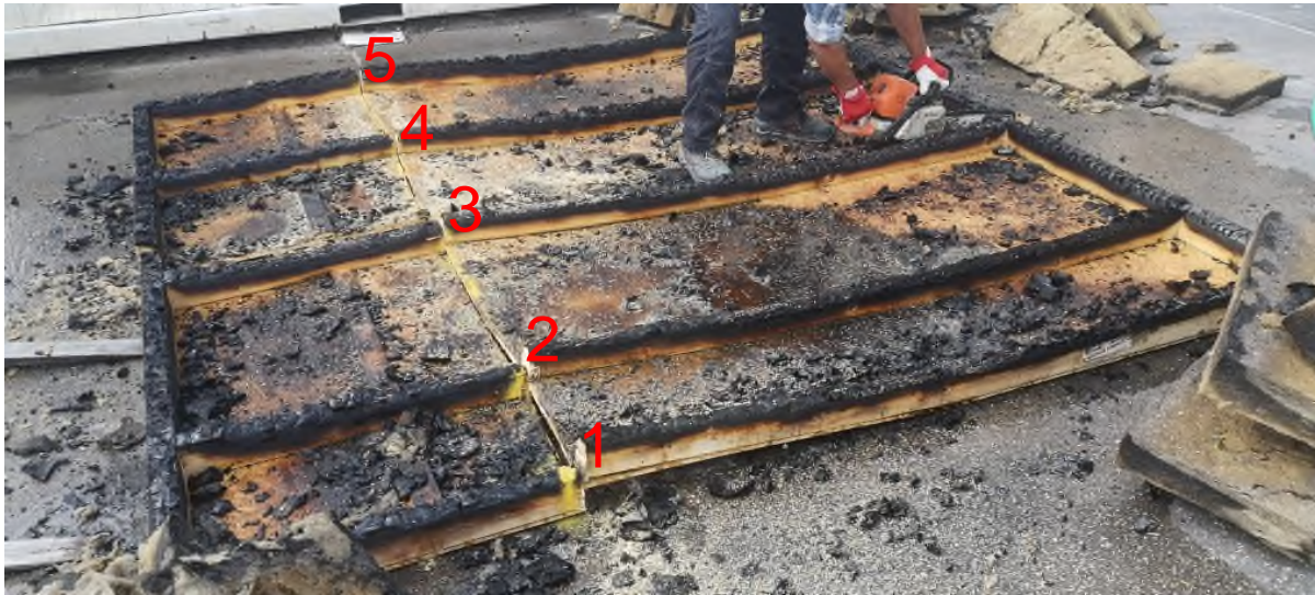
Bild 10 Blick auf den abgelöschten Probekörper; Reste der Gefachdämmung entfernt; Ständer (fortlaufend nummeriert) zur Dokumentation ihrer Restquerschnitte ca. 1000 mm vom oberen Probekörpertrand aufgetrennt.
